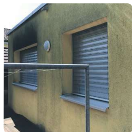
Fassade mit Algen- und Flechtenbefall.
