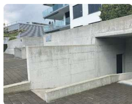
Mit dem Spezialreiniger Beton ca. 1 Jahr später.
