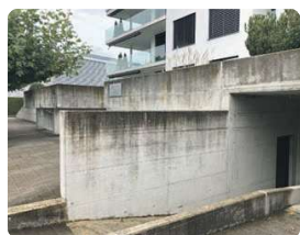
Verschiedene Steine und Beton mit Algen- und Flechtenbefall.
